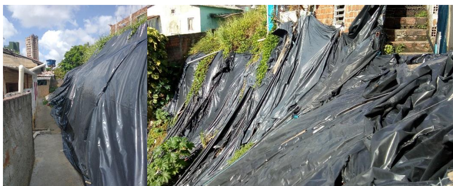
Figura 6 – Registros fotográficos de alguns pontos da encosta, evidenciando a presença de lonas plásticas. Fonte: Elaborado pelos autores (2026)
