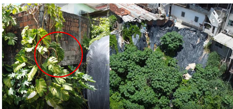
Figura 9 – Registros fotográficos da presença de fissuras e rachaduras nas edificações como sinais de escorregamentos recentes. Fonte: Elaborado pelos autores (2026)
