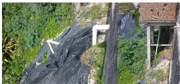
Figura 5 – Registros fotográficos de descarte de água servida sobre a encosta. Fonte: Elaborada pelos autores (2026)
