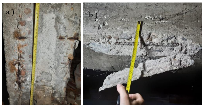
Figura 15. a) Desagregação pilar P18 devido a umidade e corrosão da armadura; b) Placa de concreto solta na viga V2.
