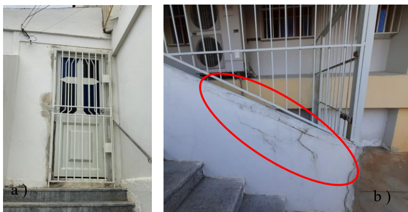
Figura 20. a) Degradação ao redor da porta da secretaria; b) Fissura no guarda corpo da escada.
