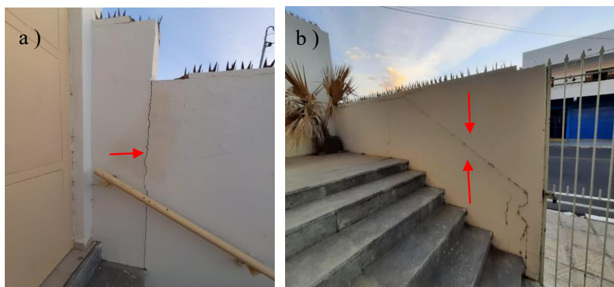
Figura 21. a) Fissura no encontro do pilar com o muro; b) Fissura entre a parede existente com o complemento construído posteriormente.
