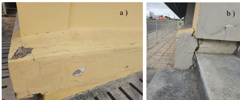
Figura 18. a) Viga V5 em estado alto de degradação. b) Rompimento do suposto elemento arquitetônico da fachada (Viga V1).
