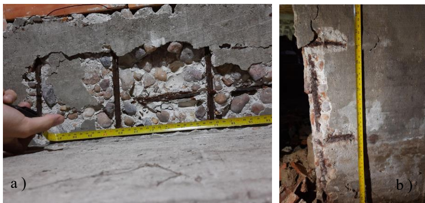
Figura 14. a) Armadura da viga exposta devido ao cobrimento insuficiente; b) P18 com Degradação armadura exposta em estado inicial de corrosão.
