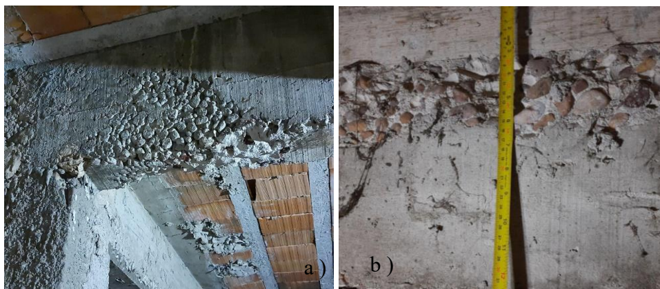
Figura 13. a) Segregação na Viga V15. b) Segregação na viga V2.
