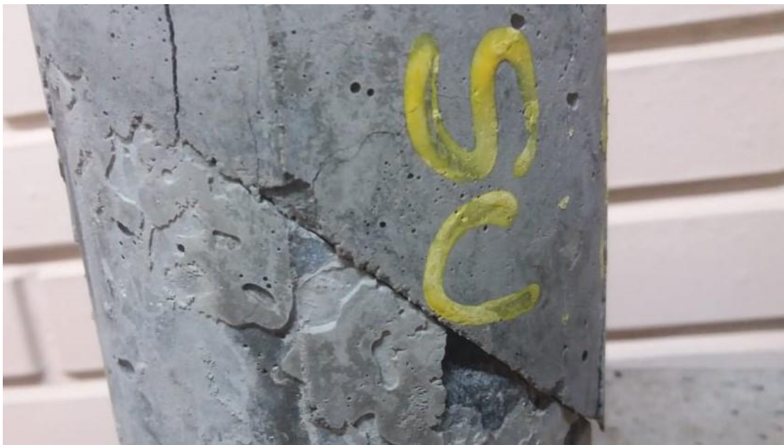
Figura 8. Ruptura na interface do corpo de prova com superfície úmida
