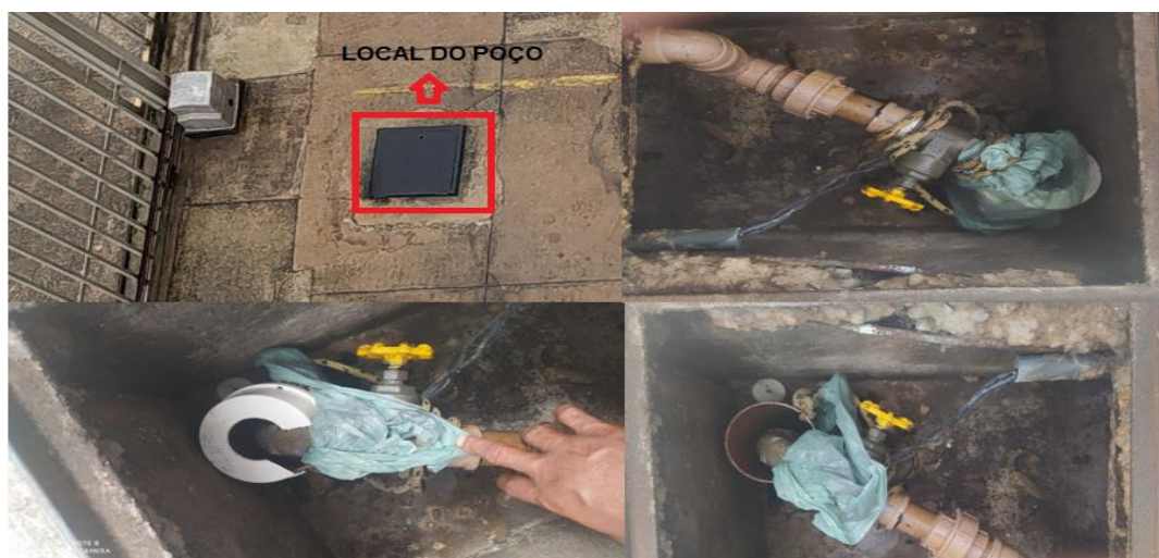
Figura 5. Desconformidades encontradas no poço em estudo
