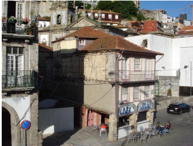
Figura 2. Taipa em parede externa – Centro Histórico do Porto - Portugal. Foto: Cybelle Miranda, 2013
