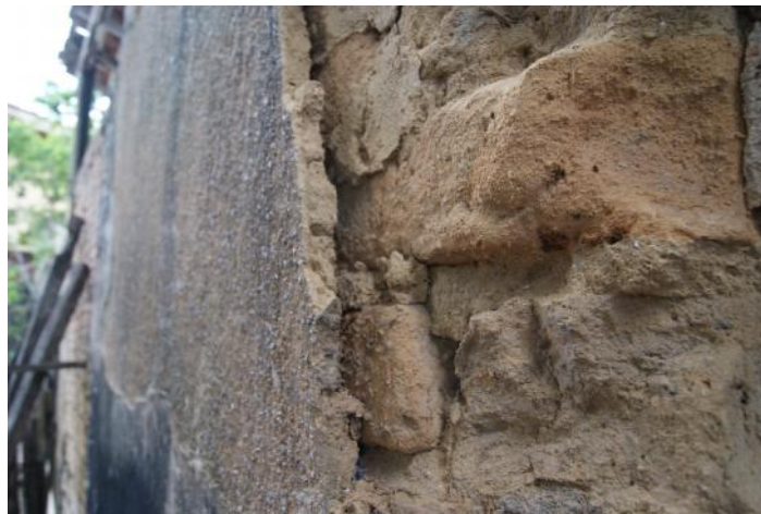
Figura 9. Detalhe da parede em taipa de mão tabique na Casa Medeiros. Foto: Fortunato Ernesto Neto, 2011
