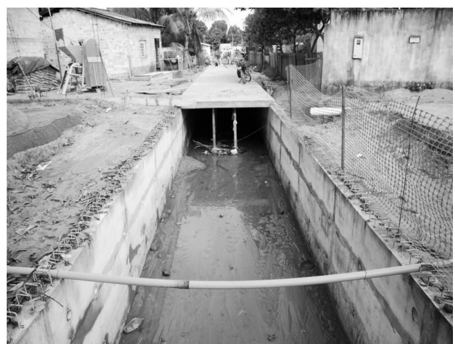
FIGURA 12 - Transformação do trecho médio do igarapé Santa Teresa em Galeria. No fundo do canal já pode ser visualizada a deposição de sedimentos. Fotografado por Carlos Sander, julho de 2008.
