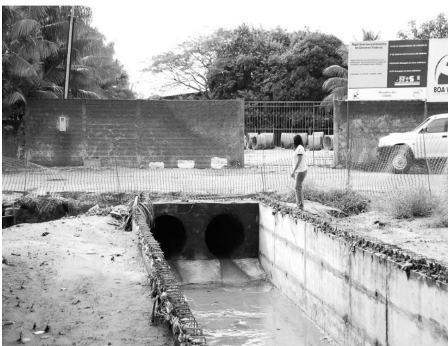
FIGURA 11 - Final de trecho de galeria que compreende o trecho superior do igarapé Santa Teresa. Ao fundo já é observada a ocupação do antigo leito por domicílios. Fotografado por Carlos Sander, julho de 2008.
