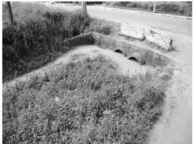
FIGURA 10 - Perda de capacidade por assoreamento de afluente da margem direita do igarapé Caraná cruzado pela Av. Ataíde Teive, bairro Operário, Boa Vista Roraima. Vista sentido jusante-montante. Fotografado por Carlos Sander, julho de 2008.
