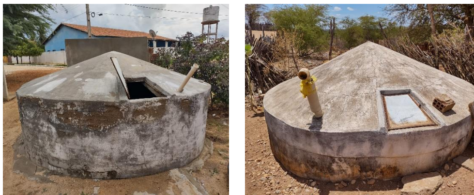
Figuras 6 e 7 – Cisternas de placa em estado de degradação. Fonte – Autores (2023).
