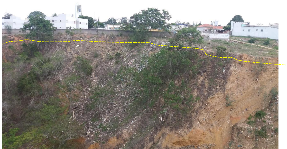
Figura 9 e 10: Despacho de resíduos sólidos em área de risco ambiental no bairro Heliópolis.
