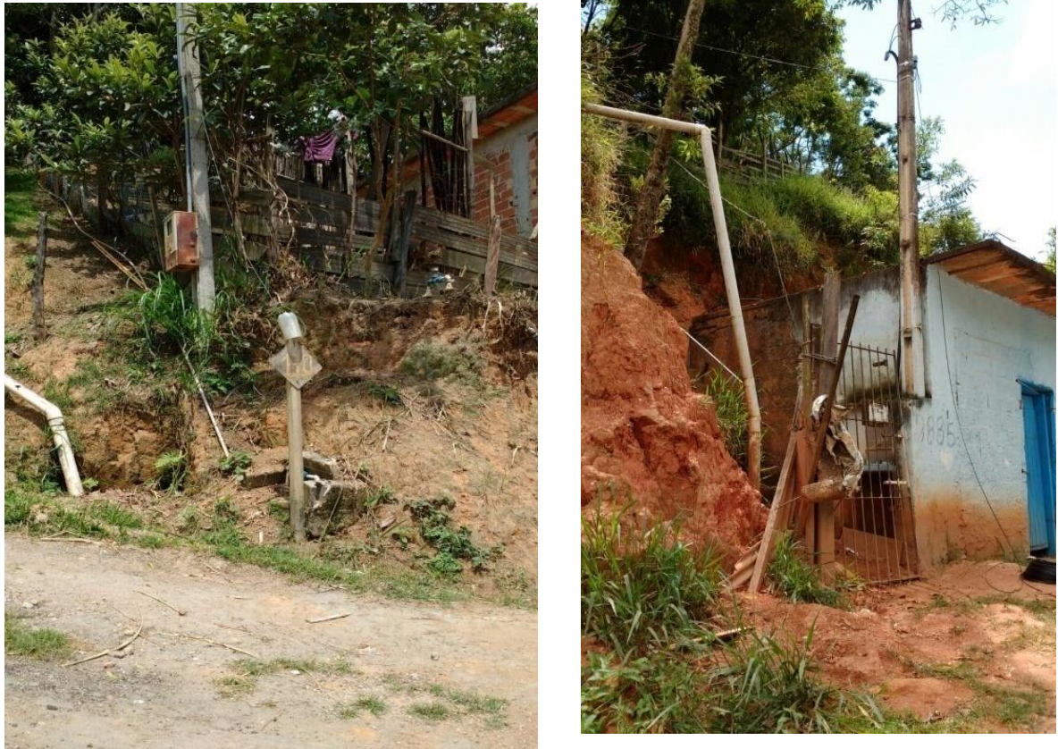
Figura 4 – Exposição de tubulações de esgoto a céu aberto
