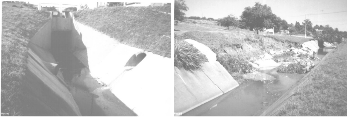
Figura 2 - Córrego do Veado, sem matéria orgânica e pouco poluído. Novembro/1991 e o desmoronamento das placas de arrimo ocasionado pela força da água do córrego, mostrando a inadequação das medidas tomadas. Novembro/1993.
