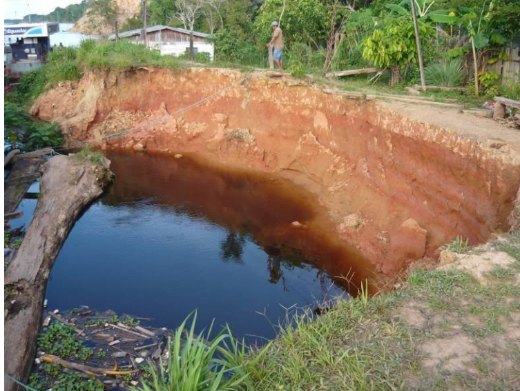
Figura 3 – Voçoroca na frente da cidade de Jutai.
