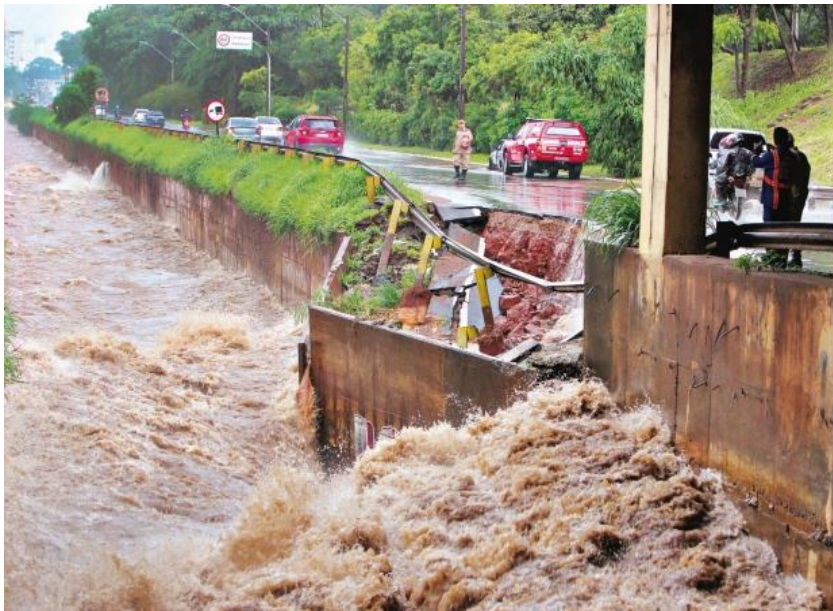
Figura 7 - Feição erosiva na Marginal Botafogo, Goiânia, 2017. Fonte: O Popular , 2017.
