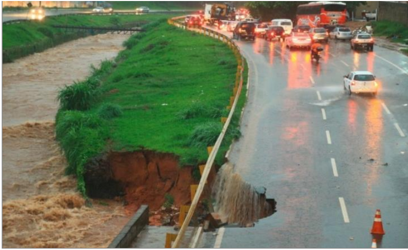
Figura 6 - Feição erosiva na Marginal Botafogo, Goiânia, 2015. Fonte: O Popular , 2015.
