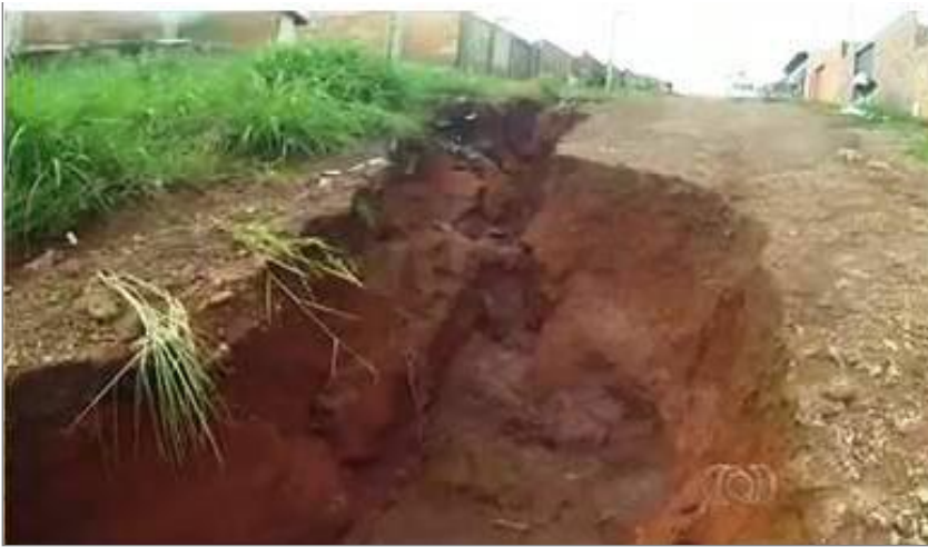
Figura 8 - Feição erosiva no bairro Real Conquista, Goiânia, 2016. Fonte: G1 Goiás, 2016.
