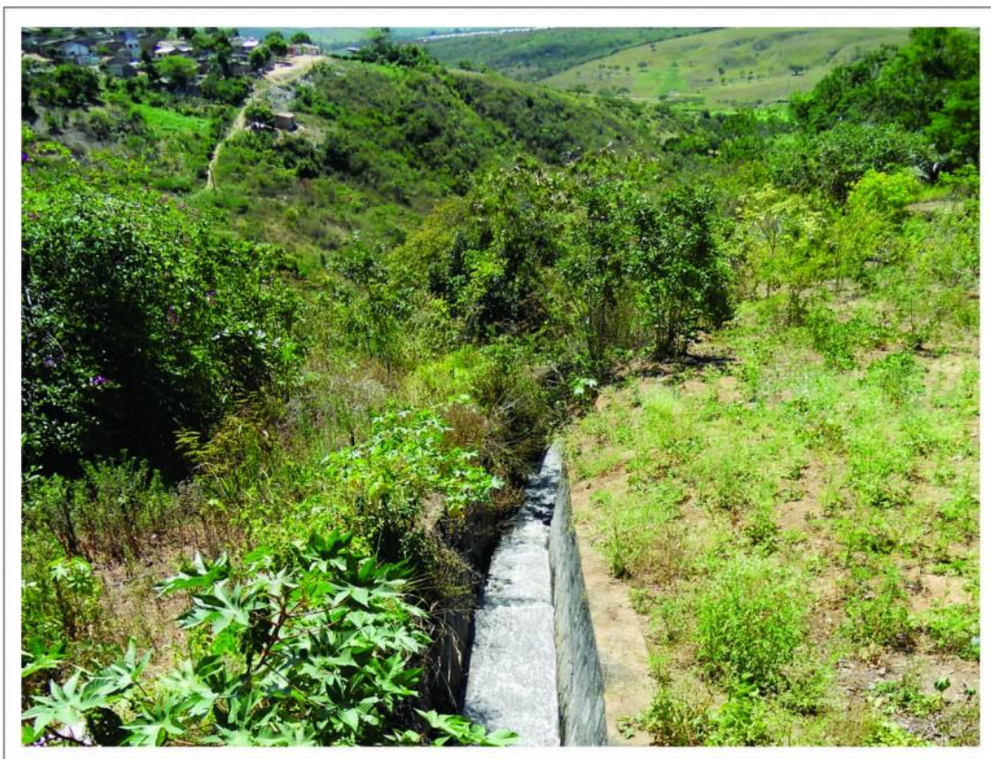
Figura 08: Obra pública municipal para condução de fluxo hídrico para o fundo do vale da Liberdade. Coordenadas geográficas da base da figura: (s) 8° 53' 27" - (o) 36° 28'42".
