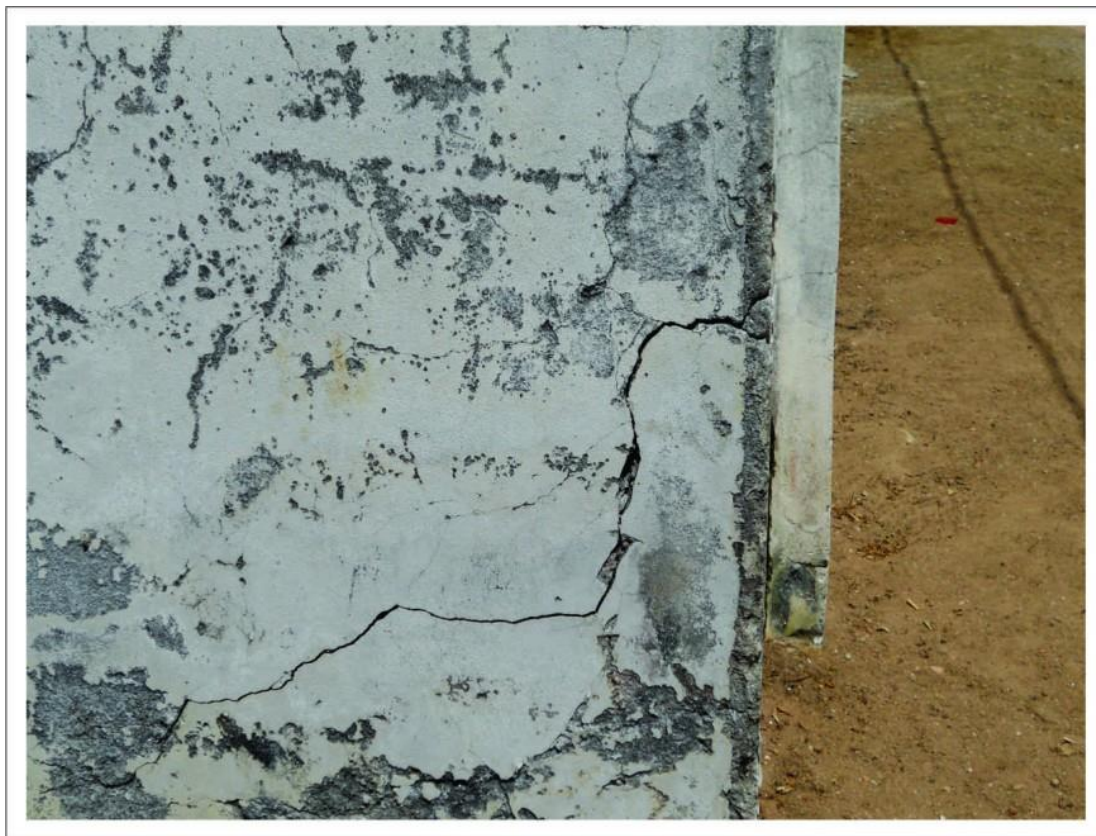
Figura 07: Fissura na estrutura de um muro de uma residência no sentido da declividade da encosta. Coordenadas geográficas da base da figura: (s) 8° 53' 26" - (o) 36° 28' 44". Fonte: MELO, 2011.
