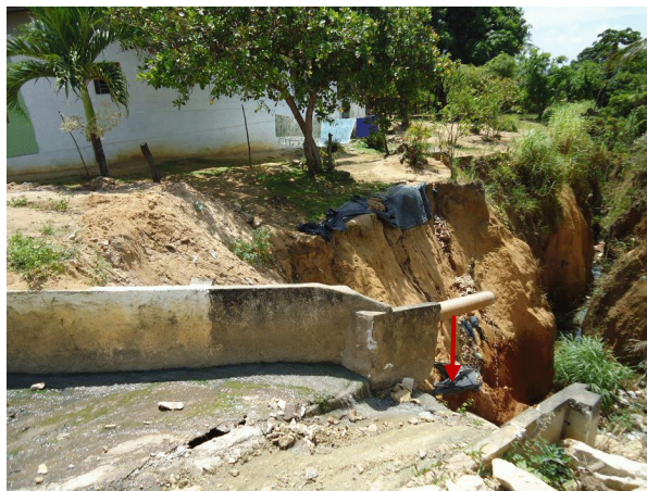
Figura 10: Voçoroca no bairro Oiteiro em Alhandra PB. Notar despejo de esgoto e escoamento de água devido às lavagens dos filtros da CAGEPA.
