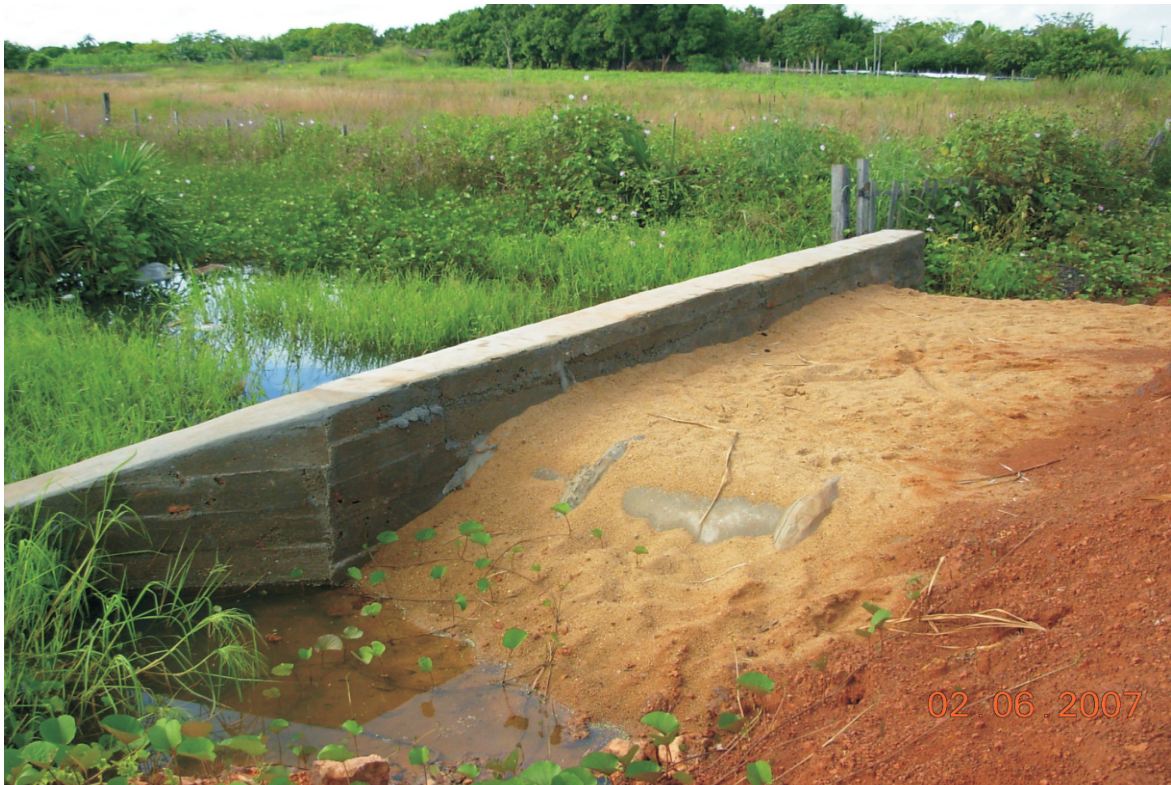
FIGURA 09: Exemplo de drenagem instalada nos lagos. Foto: Acervo de João Theófilo Rocha Pereira e Alysson Rogers Soares Macedo, 2007.
