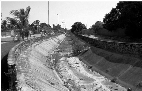
Figura 04: Trecho canalizado do igarapé Mirandinha, onde se observa a ausência de fluxo de água. (Tonello, 2006).
