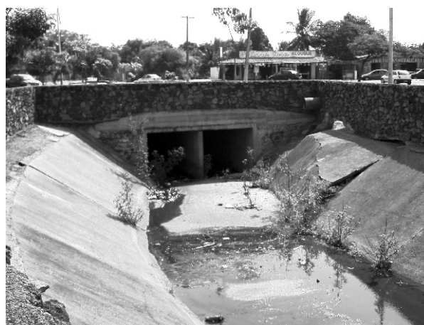
Figura 10: Esgoto no trecho canalizado do Igarapé Mirandinha. (Tonello, 2006).
