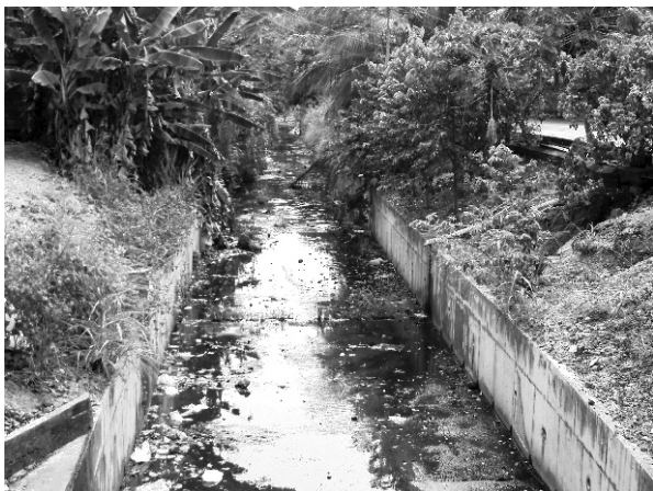
Figura 12: Presença de lixo e esgoto no trecho canalizado do Igarapé Mirandinha. (Tonello, 2006).
