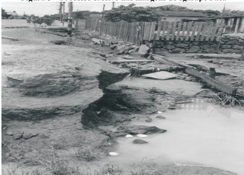
Figura 3 – Processo erosivo nas margens do Igarapé Paca
